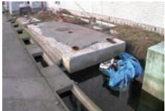
写真5 タンク室周囲の洗掘2
