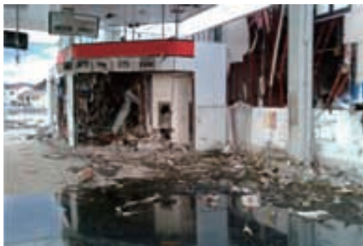
写真25 破壊された事務所建物
