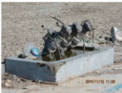
写真19 損傷した注入口 1
