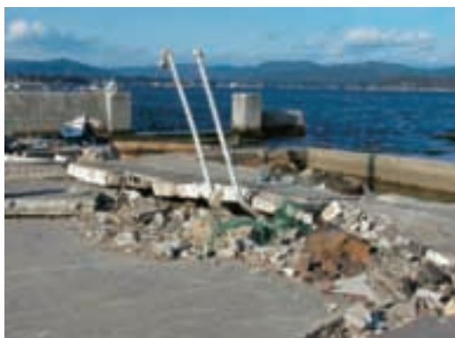
写真18 防火塀に押し曲げられる通気管
