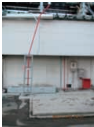
写真16 上部が曲がった通気管
