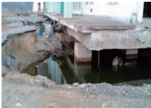
写真3 周囲の地盤沈下
