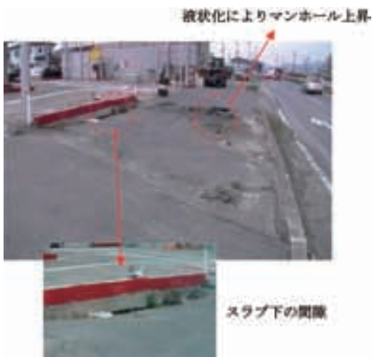
写真9 スラブ下の間隙被害
