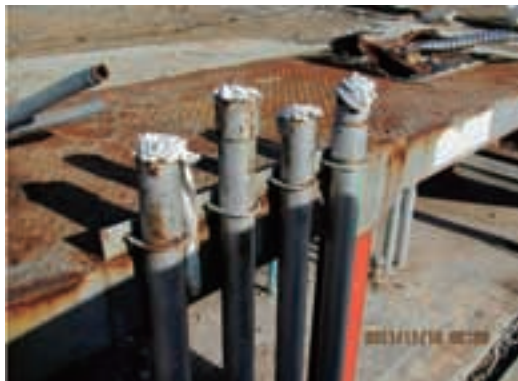
写真15 上部が欠損した通気管
