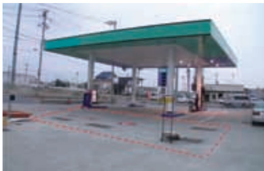
写真10 スラブ下に間隙が生じた給油取扱所 (赤点線で囲ったスラブ下に間隙が発生)
