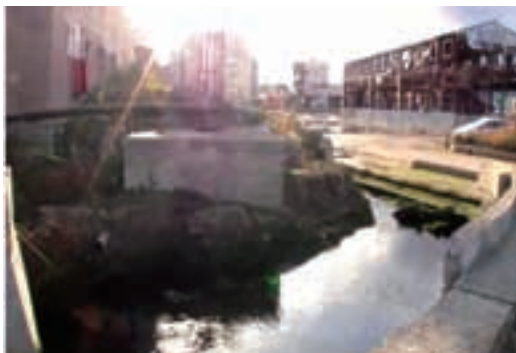
写真4 タンク室周囲の洗掘1
