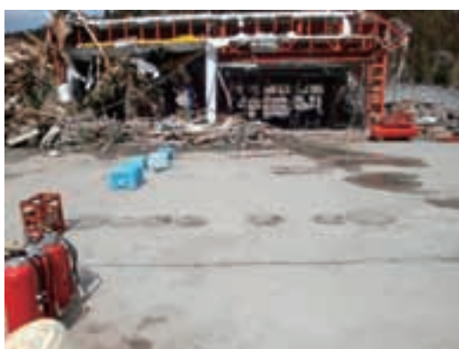
写真24 骨組みが露出した事務所建物 6)
