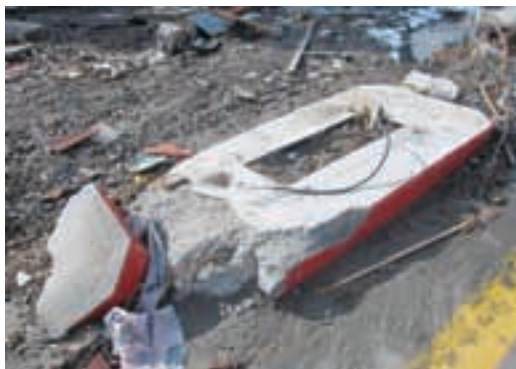
写真11 固定給油設備が欠損したアイランド 6)
