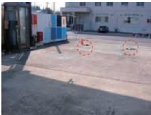
写真7 地下貯蔵タンク浮上2 (マンホールから配管が飛び出している)
