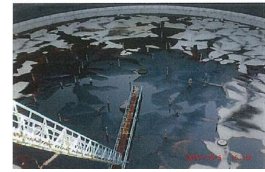
デッキ上への漏洩状況
