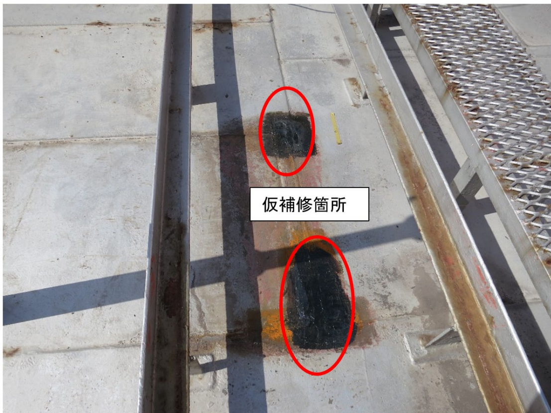
図3-2 浮き屋根の仮補修 (アクアパテ+ウルトラシール+エラストマー)
