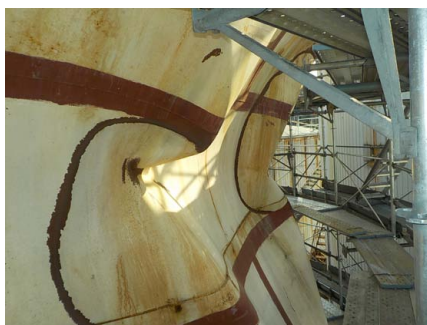
(写真8) 西側変形
