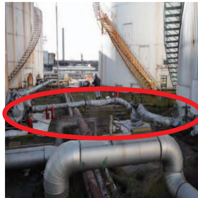
(写真7) 仮設移送配管
