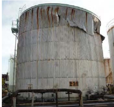
(写真1) タンク本体北側
