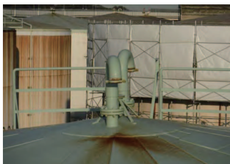
(写真5) 隣接タンク上から撮影した通気管
