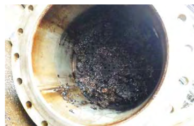
写真6. 蒸留塔と熱交換器間の黒色堆積物
