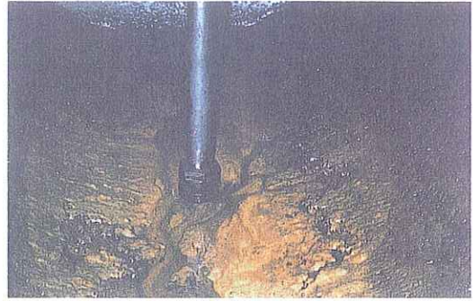
50,000 ℓ 地下タンク貯蔵所（設置後10年） 汚れ状況
