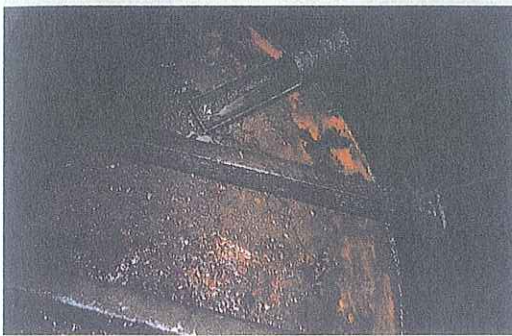
10,000 ℓ 屋外タンク貯蔵所（設置後8年） 灯油タンクの汚れ状況
