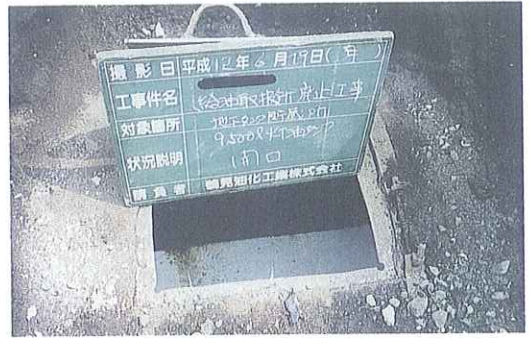
9,500ℓ閉塞型灯油タンク 開口
