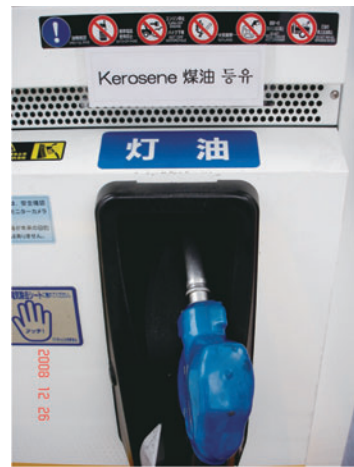
灯油の危険物標示板
