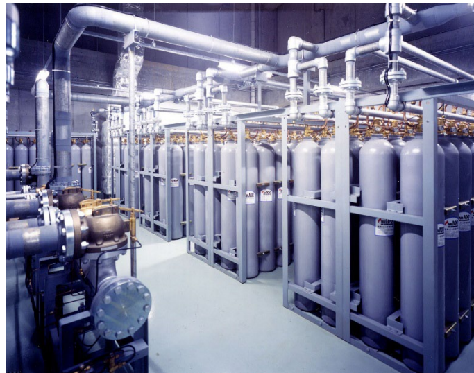
写真1 消火剤貯蔵容器
