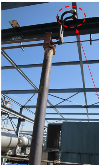
写真1 リサイクルガス コンプレッサーバント
