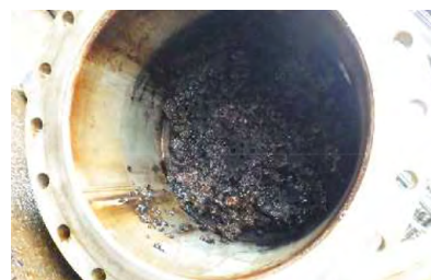
写真6. 蒸留塔と熱交換器間の黒色堆積物の状況
