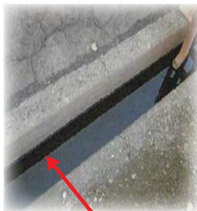
原油タンク側溝への原油の漏れい状況
