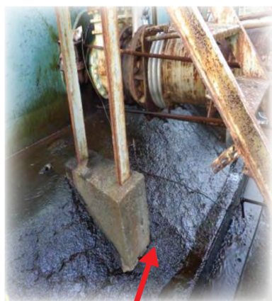
犬走りの原油の漏れい状況
