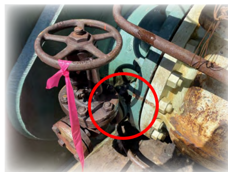
漏えい箇所拡大(2Bノズル)
